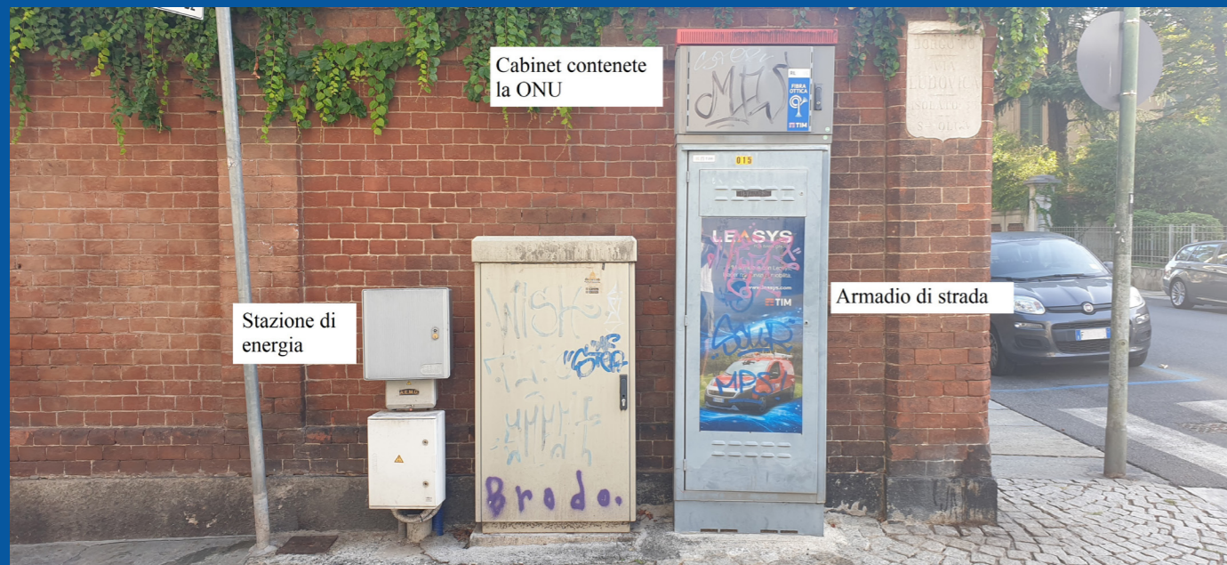
Figura A: Cabinet ONU e stazione di energia dedicata
